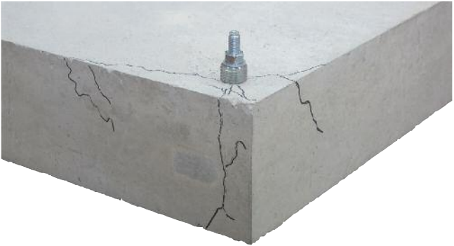
Bild 7.6: Auftreten von Spaltrissen bei der Montage eines drehmomentkontrolliert spreizenden Dübels in Beton bei Unterschreitung der Mindest- randabstände und/oder Überschreitung des Montagedrehmoments
