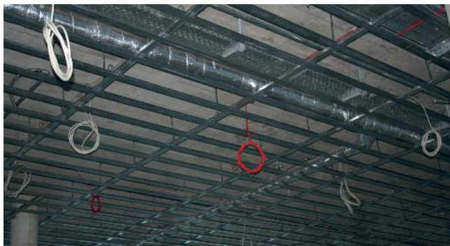
Bild 8.9: Befestigungen von angehängten Decken sind jetzt im bauaufsichtlich relevanten Bereich mit modernen Kunststoffrahmendübeln möglich
